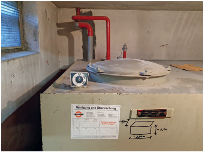
Stahltank für das Heizöl
