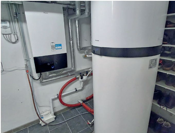
Steuerung Wärmepumpe (WP) und separater Wassertank mit aufgesetzter WP
